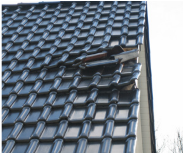
Sturmschaden Steildach; Foto FOS
