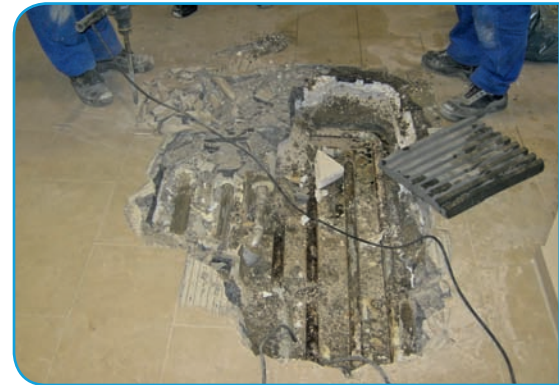
Bild 7 | Die Heizungsrohre sind innerhalb der Wärmedämmung korrodiert.
