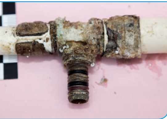
Bild 5 | Detail des schadenauslösenden T-Stücks. Auf dem Stützkörper sind beide O-Ringe vorhanden. Die korrodierten Presshülsen sind bereits gerissen. Eine kraftschlüssige Verbindung ist damit nicht mehr gegeben.
