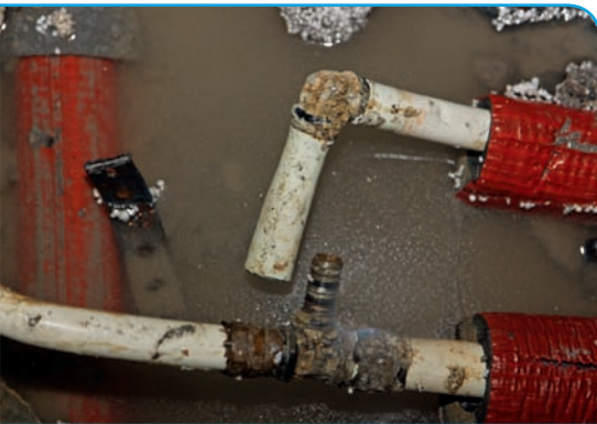
Bild 4 | Detail der getrennten Pressverbindung. Die Presshülse ist nicht mehr vorhanden! Die äußeren Verformungen des Mehrschichtverbundrohres zeigen jedoch an, dass sich dort ursprünglich eine Presshülse befunden hat.
