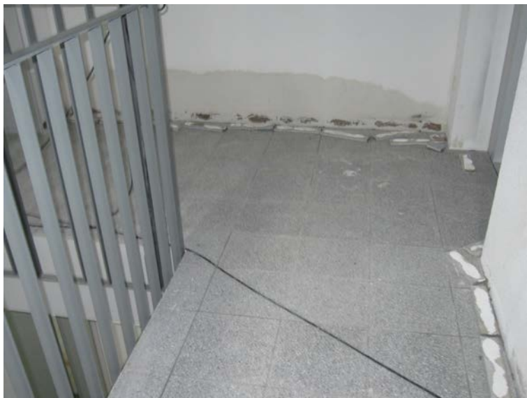
Abbildung 04: Wasserhochzug an der Wand mit schimmelpilzartigen Strukturen
