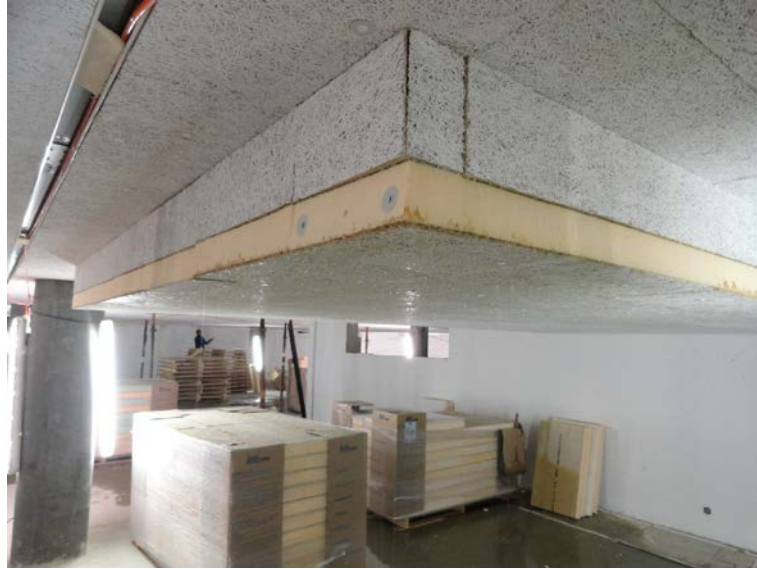
Abbildung 06: Falsch gelagerte Baumaterialien. Erkennbar auch an den Wasserspuren an den Dämmplatten.
