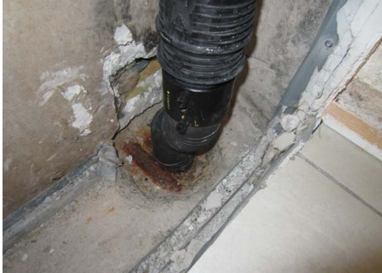
Abbildung 03: Verdeckter Wasserschaden – Wasseraustritt blieb lange Zeit unbemerkt
