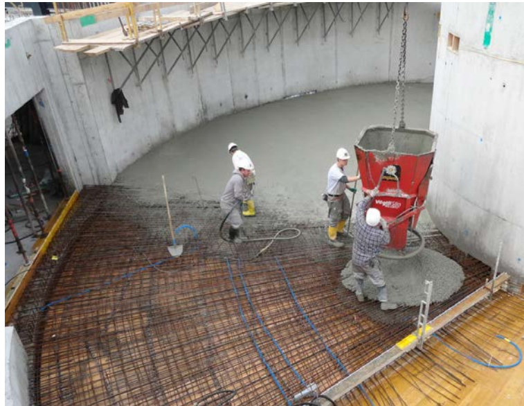
Abbildung 01: Betonieren einer Geschossdecke. Durch die Verarbeitung gelangen große Mengen Wasser in den Neubau.
