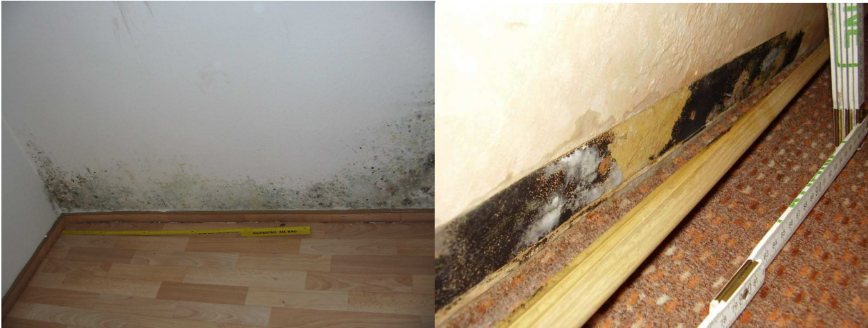
Abb. 1 und 2: In beiden Fällen ist neben einem sichtbaren Befall an der Wand oder einem verstecktem Befall hinter einer Fußbodensockelleiste von einer Schimmelpilzbelastung in der Dämmebene des Fußbodens auszugehen (Bilder Institut peridomus, www.peridomus.de )
