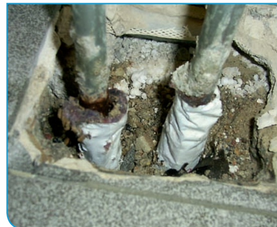
Bild 3 | Innerhalb der filzhaltigen Rohrhülle ist die korrodierte Außenseite des Heizungsrohres zu erkennen.
